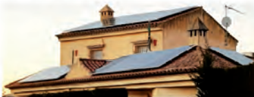
Instalación PV sobre tejado en una vivienda unifamiliar del Aljarafe sevillano
