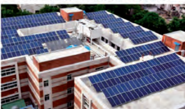
Instalación PV sobre cubiertas de bloques de pisos en la provincia de Málaga [Fuente: https://www.enarsolul.com/instalaciones/ ]
